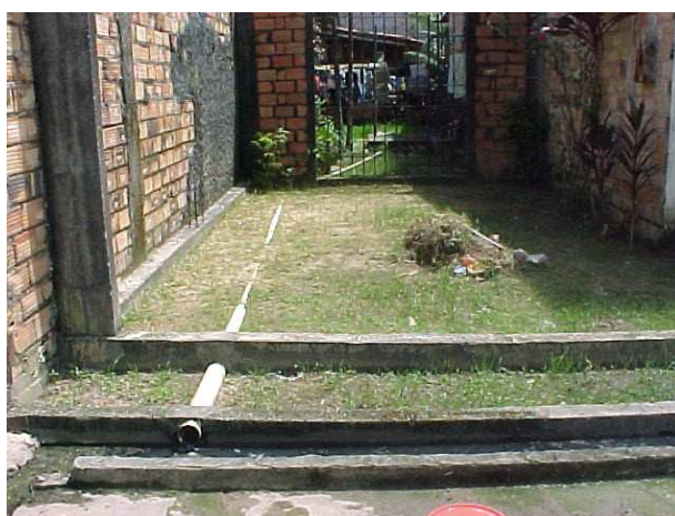
Fotografia 28: Detalhe da ligação do tanque séptico da casa nº 128 na vala de drenagem
