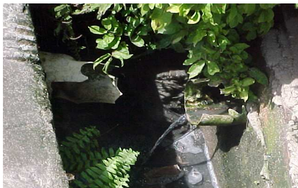
Fotografia 16: Detalhe do desaguamento da casa nº 48
