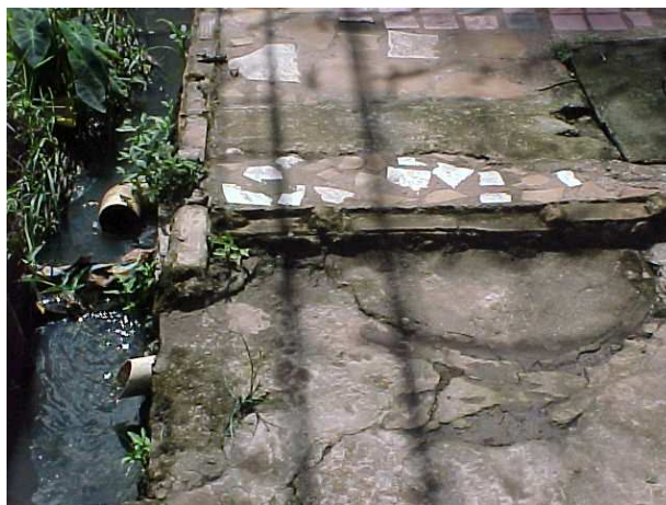
Fotografia 21: Caixa de ligação vedada e o detalhe do extravasor feito na casa nº 22-A
