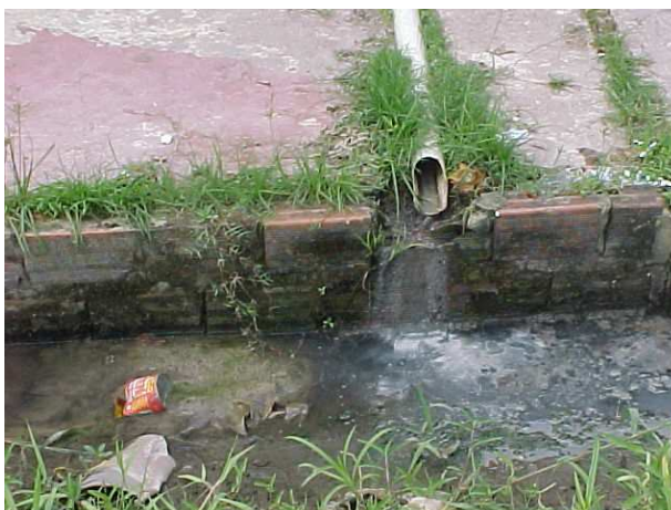
Fotografia 26: Contribuição do esgoto sanitário dos banheiros na Passagem Manoel Pinho nº 44
