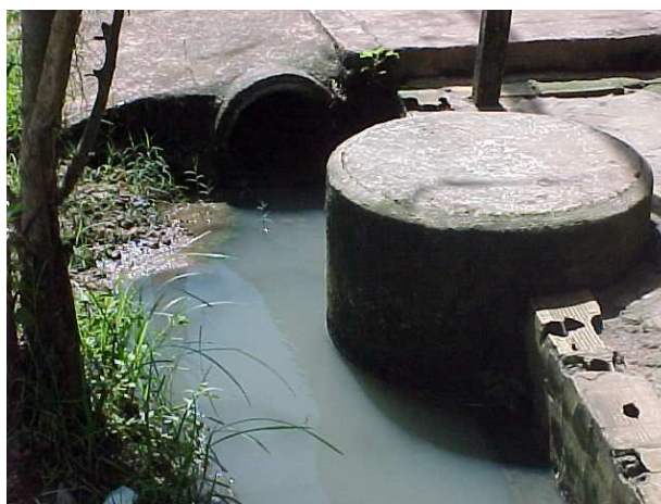
Fotografia 22: PV desativado localizado na Passagem Santa Inês, em frente à casa nº 164
