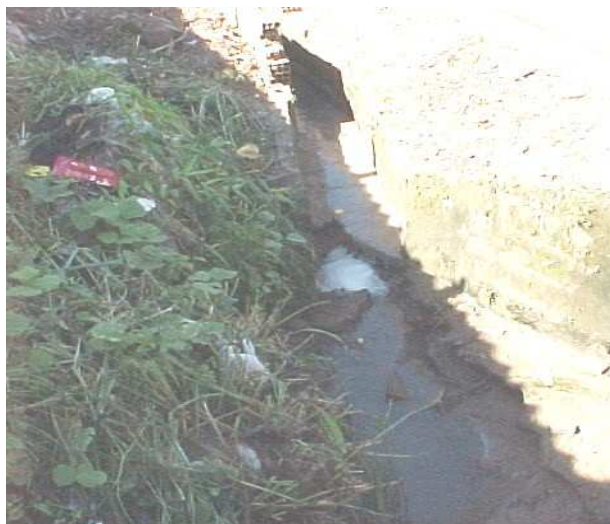
Fotografia 34: Detalhe da vala de drenagem com a contribuição do resíduo sólido e de esgoto sanitário
