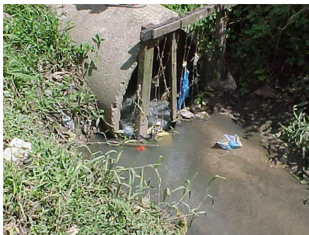
Fotografia 36: Contribuição de esgoto na rede de drenagem na esquina da Passagem Manoel Pinho com Rua 10 de Maio II
