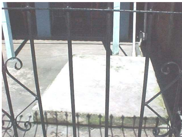
Fotografia 10: Tanque séptico da casa nº 05
