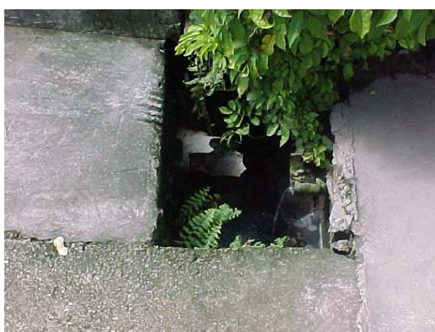
Fotografia 17: Detalhe do rompimento da tubulação de ligação da casa nº 48
