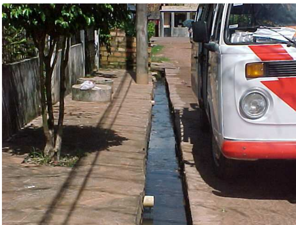
Fotografia 19: Detalhe da tubulação e PV's na Passagem Santa Inês em frente à casa nº 161
