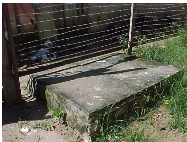
Fotografia 15: Tanque séptico da casa 75-A
